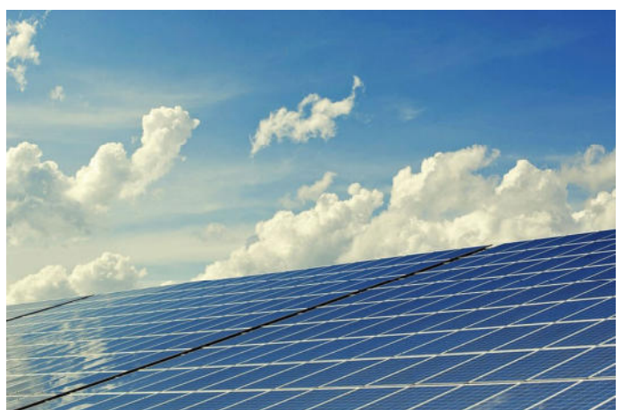
Photovoltaik-Anlagen erzeugen mit Hilfe der Sonne elektrischen Strom.
